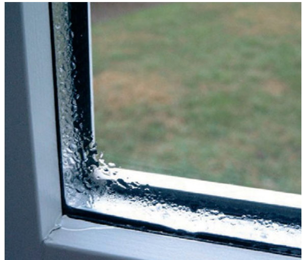
Kondensat im Randbereich der Innenscheibe
