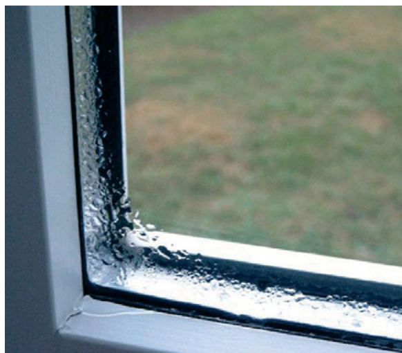
Condensation au niveau du bord de la vitre intérieure
